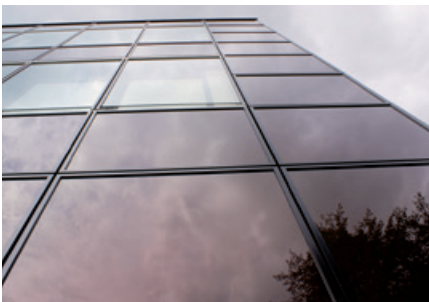
Kaltfassade mit integrierten Photovoltaik-Modulen, VFF / Anders Metallbau GmbH
